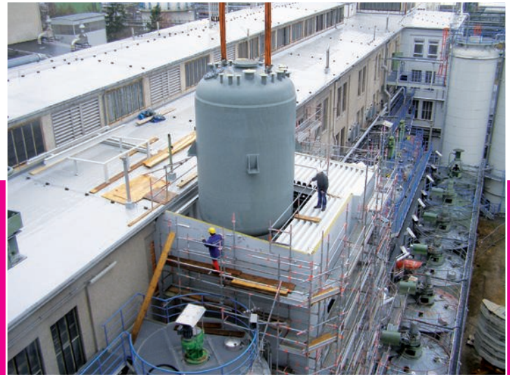
Neuer Polymerisationskessel zur Herstellung von Pasten-PVC in der erweiterten Pasten-Anlage Burghausen
