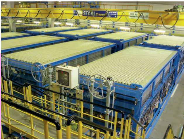
Zellensaal der Membranelektrolyse Gendorf
