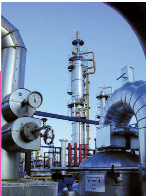
VCM-Anlage, Vintron Knapsack
